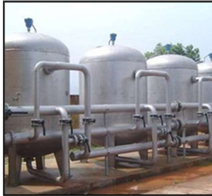
Bể lọc than hoạt tính
