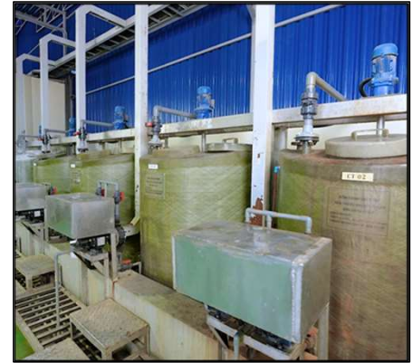
Hệ thống lọc RO
